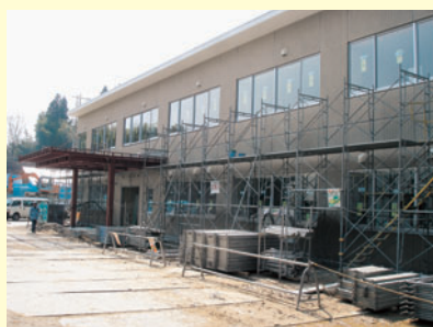
H20.3 外側の足場が外れて
