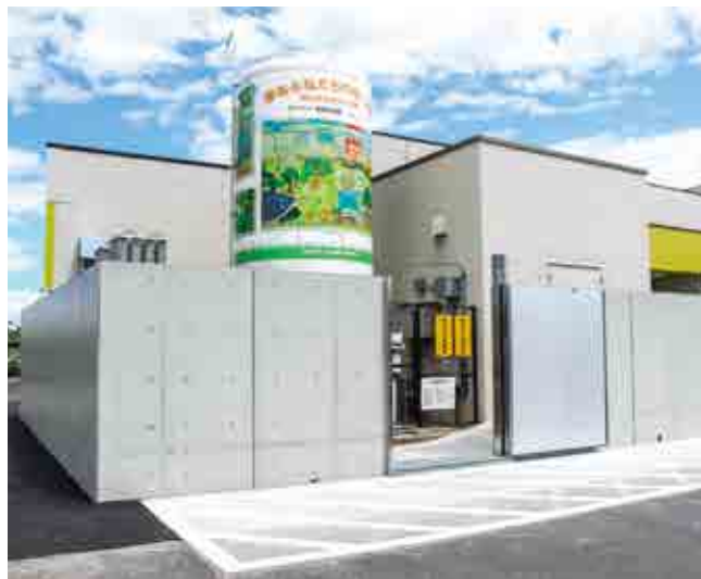
①医療ガス防水壁 (遮水扉開)
