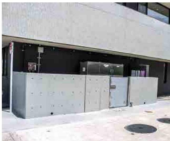
⑤非常用発電機 防水壁・遮水扉
