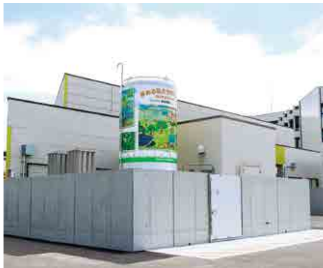
①医療ガス防水壁 (遮水扉閉)
