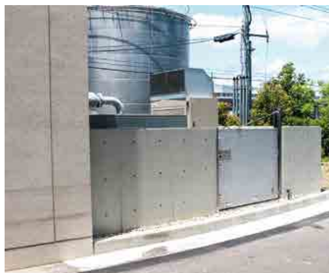
④RI排水防水壁・遮水扉
