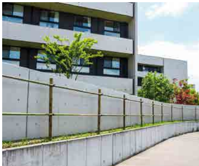
②コンクリート防水壁（病棟外周）
